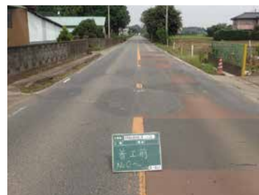
路面が荒れ、ラインもところどころ消えかかっていた改修前の道路
